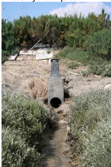
Photo 7 : Exemple de prise d'eau à la mer de C1
